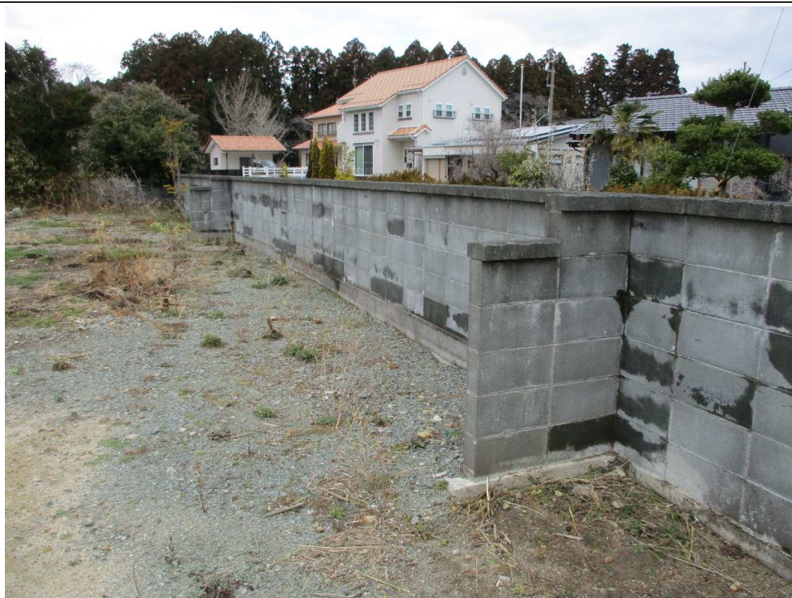
(19) 北側ブロック塀
